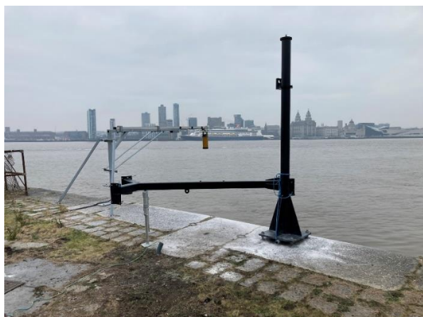
Figura 17 Brazo de radar instalado y balanceado tierra adentro.
