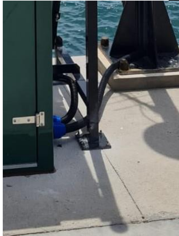
Figura 13 Conducto desde el gabinete hasta el mástil GNSS.
