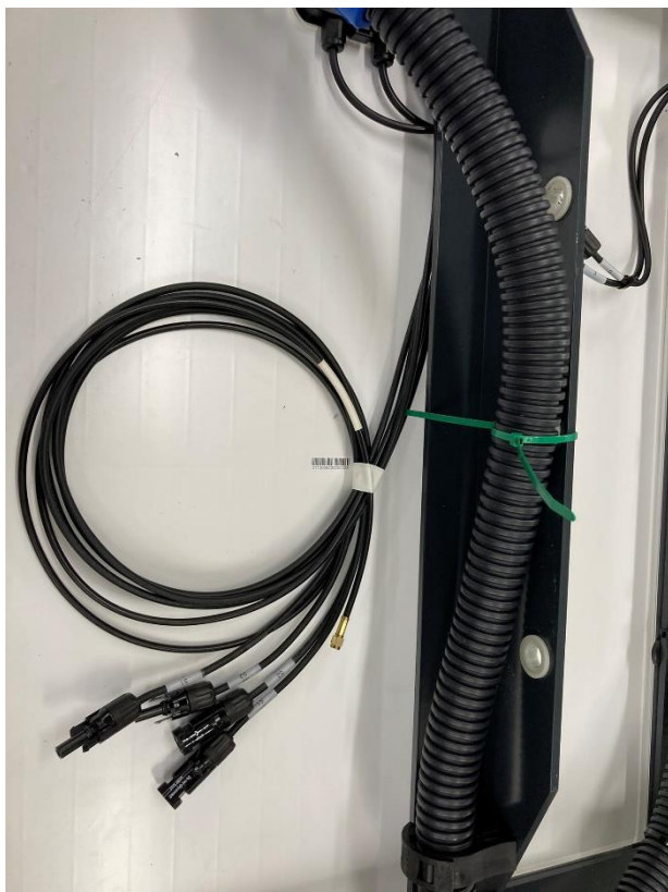
Figura 34 Cables de paneles solares.
