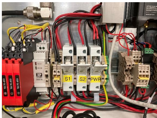
Figura 44 Fusibles de la carcasa del registrador en posición abierta.
