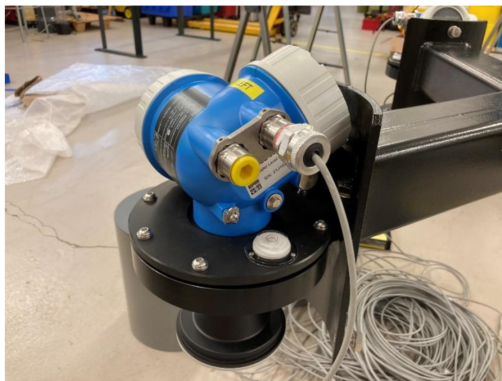
Figura 22 Sensor de radar instalado en el brazo del radar.
