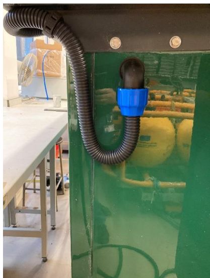
Figura 15 Conducto del cable del panel solar.
