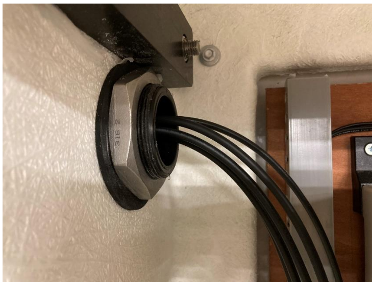
Figura 16 Entrada del cable del panel solar.
