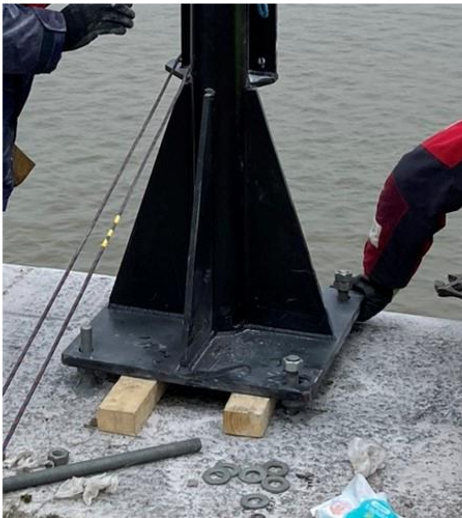
Figura 9 Pernos de anclaje del mástil GNSS.
