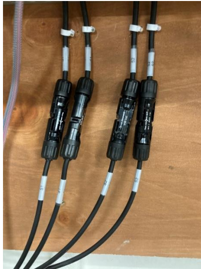
Figura 46 Cables del panel solar conectados al sistema.
