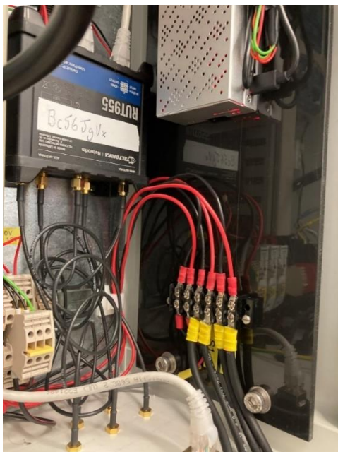
Figura 50 Batería y bloque de terminales solares.
